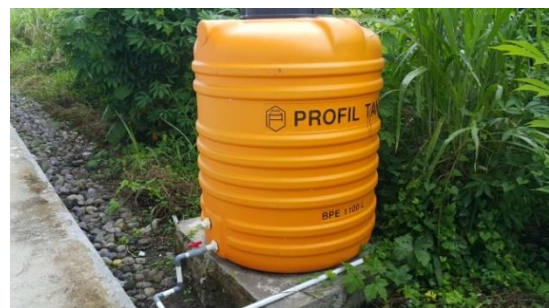
Gambar 5. 10 Toren Air Untuk Gedung Rawat Inap
