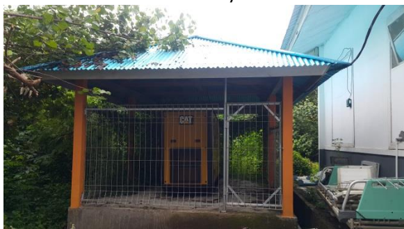
Gambar 5. 35 Genset Baru dan Fasilitasnya Miliki RSU Sofifi
